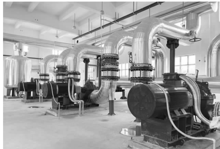
翟店街道中继泵站。
