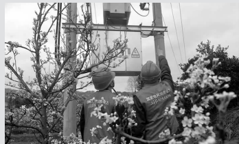
3月16日,湖南怀化靖州供电公司党员服务队队员张林、刘泽辰巡检10千伏林源线坝阳坪变压器台架。 石云昌摄
