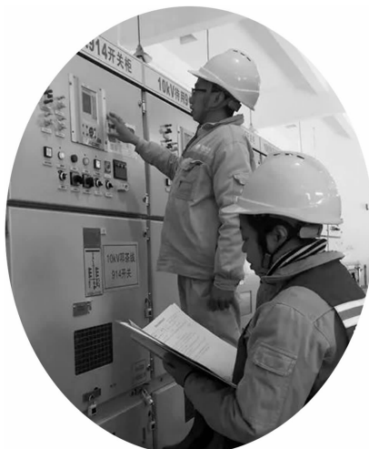
3月19日,四川遂宁供电公司员工敬小琴、何军在110千伏夏邛变电站开展10千伏邛茶线914开关柜保护装置定值倒闸操作。 胡学高摄
