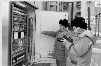
3月17日,冀北电力超高压公司员工韩涛、靳永轩在1000千伏张家口变电站为二次设备红外测温。 王京京摄
