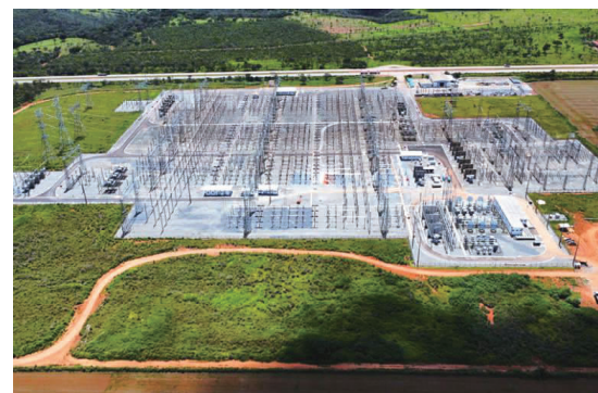
▲ 巴控公司路易斯安纳变电站扩建项目。资料图片
