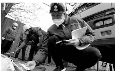
3月27日,山东莱芜供电公司安全督察人员在35千伏高庄站10千伏华迪线带电作业现场检查安全工器具使用期限。 王宪才摄
