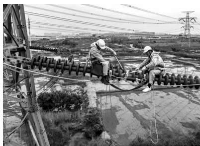
3月24日,安徽马鞍山供电公司员工检查500千伏新涂线12号塔上设备。 常舜禹摄
