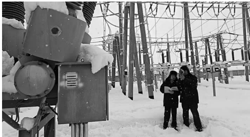
5月4日,新疆哈密供电公司员工姚自阳、买买提·阿斯夫雪后特巡220千伏山北变电站站内设备。 冀宏浩摄
