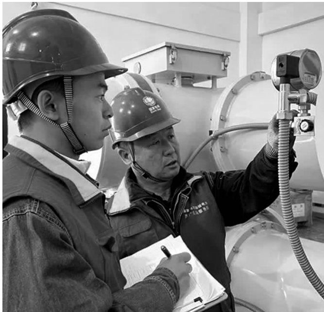
5月5日,新疆伊犁伊河供电公司员工薛文峰、夏亚军在110千伏制造区变电站对站内六氟化硫密度继电器开展漏点检查。 袁诗洋摄
