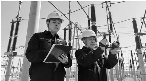
5月3日,黑龙江牡丹江供电公司员工在220千伏林口变电站巡检站内设备。 张健摄
