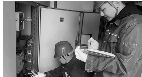
5月4日,黑龙江大庆供电公司员工张宇恒、田传文巡检6千伏乘风湖东线乘风098箱式变压器运行情况。 姜欣摄
