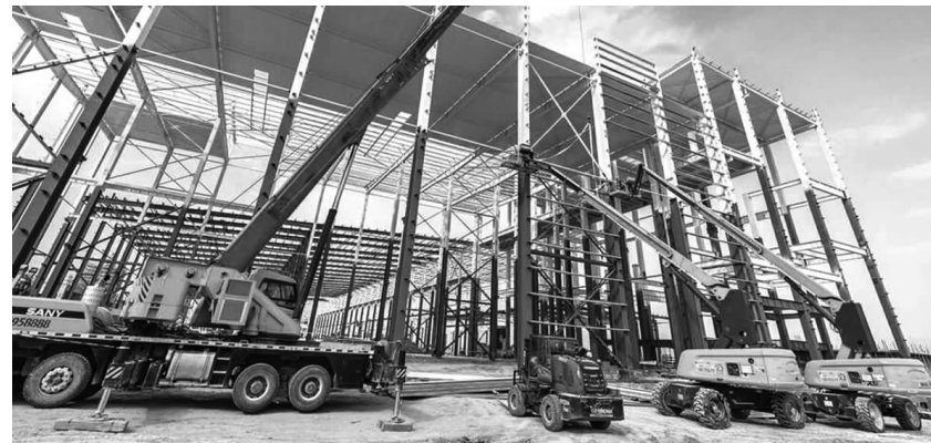
5月22日,位于运城经济技术开发区的亚新科工业技术(运城)汽车零部件制造基地(一期)项目正在加快建设。该项目总投资10.5亿元,其中一期投资6.81亿元,建设年产6万吨的汽车零部件毛坯生产线和配套智能加工生产线。项目建成后,一期工程可实现年销售收入约8亿元,解决近千人就业,实现利税8000万元。 闫鑫 摄
