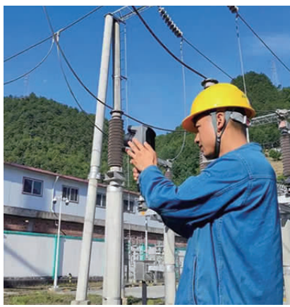
6月10日，甘肃陇南供电公司员工孙宏斌在110千伏康县变电站巡检站内设备。 李小龙 李霞 摄影报道
