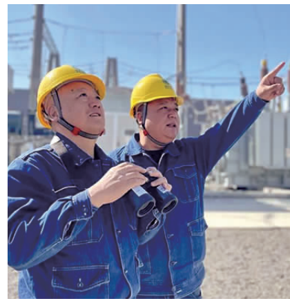
6月11日，新疆塔城供电公司员工范胜安、徐才益在110千伏裕民变电站巡检站内设备。 梁峰 摄
