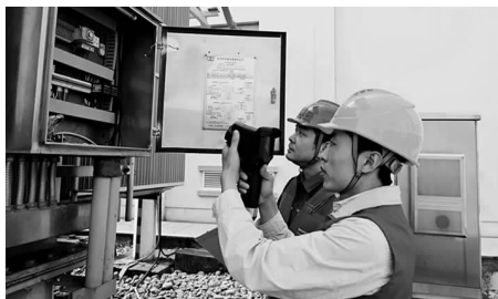
5月12日，浙江温州供电公司员工张天柱、林日成在110千伏马屿变电站巡检设备。 陈海卯 孟航摄影报道
