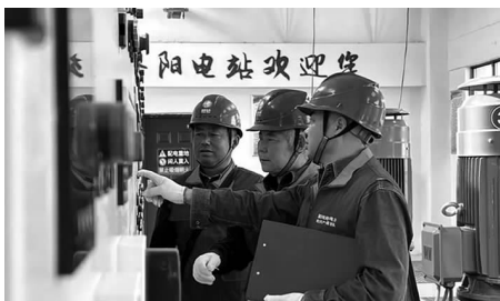
5月11日，安徽滁州明光供电公司党员服务队队员顾现兵、殷勇刚、吴启部巡检35千伏紫阳电力排灌站用电设备。 吕凌波摄
