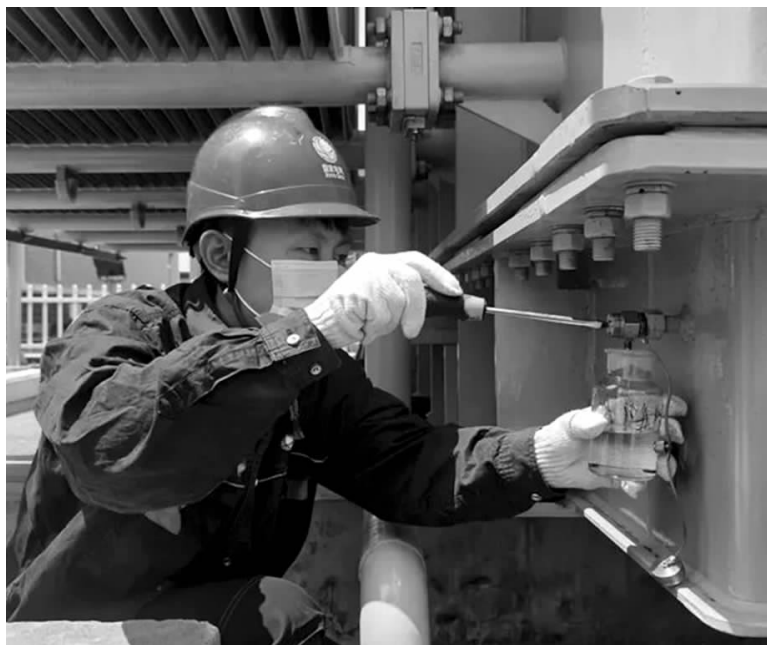
5月13日，辽宁大连金州新区供电公司员工王添翼在66千伏官家变电站取1号主变压器的油样。 马福多摄
