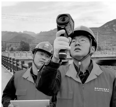
5月10日，甘肃天水武山供电公司员工卢军贤、曾富强巡检10千伏114马王线马力9号配电变压器。 孙昀晖摄
