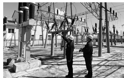
5月15日，黑龙江红兴隆供电公司员工刘军、姜涛巡检66千伏南横林子变电站设备。 李悦摄
