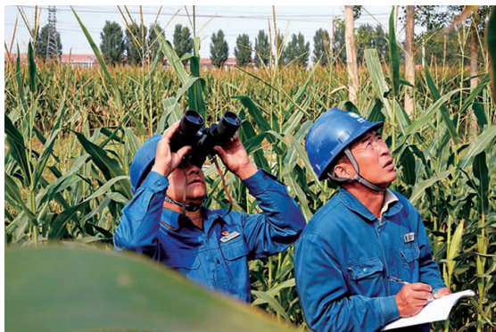
9月3日，山东济南济阳供电公司员工苏传银、陈卫东在新市镇小刘村巡检10千伏新牛线13号杆。 陈彬 摄
