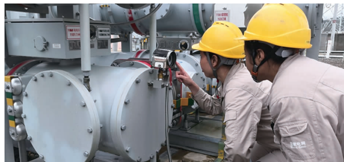
9月3日，四川遂宁供电公司员工敬小琴、王加春在110千伏理塘变电站观测110千伏母线分段气压值。 胡学高 摄
