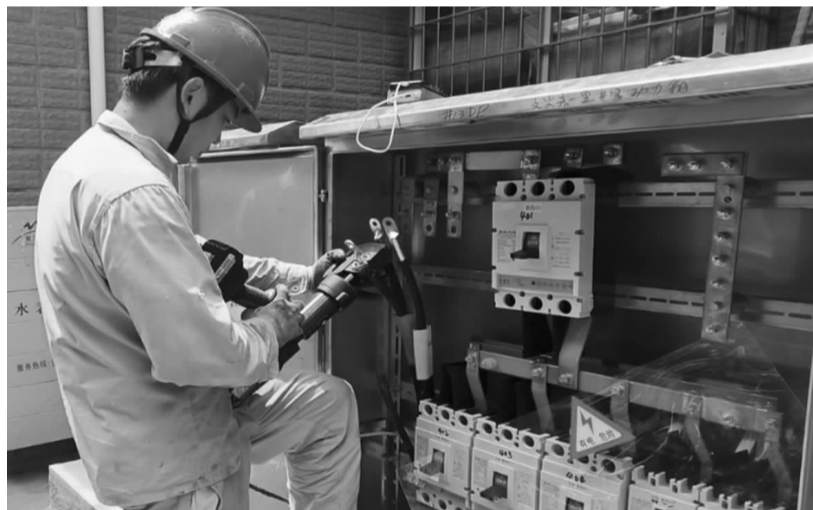
配网项目物资现场暂存点有力保障工程施工进度
