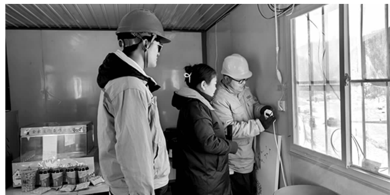
工作人员检查线路
