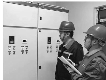
检查变压器设备
