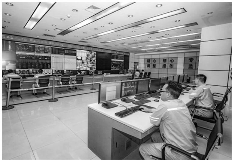
图为陕煤电力运城公司职工在集中控制室操作发电机组
