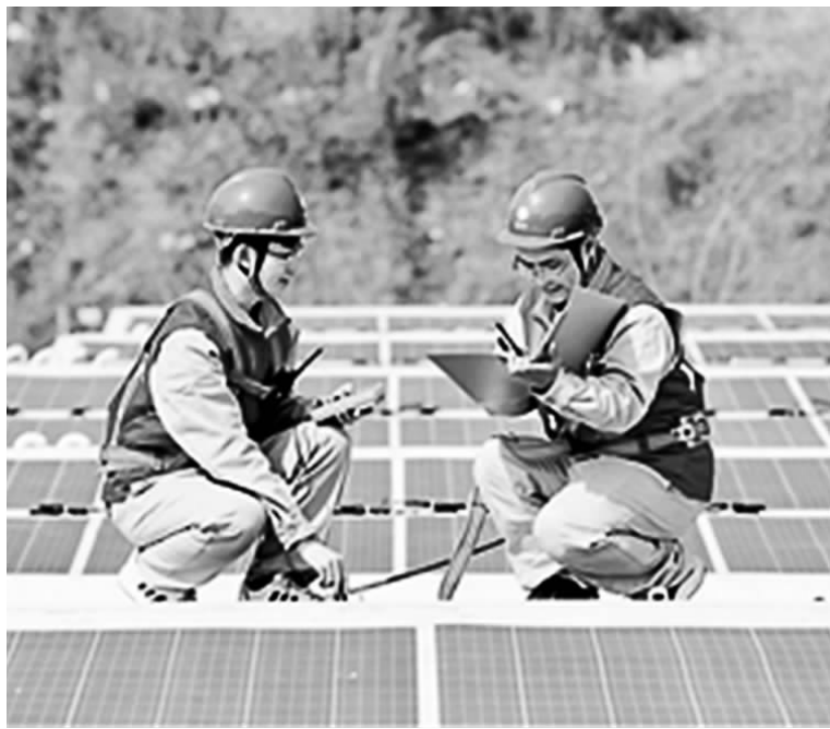
国网江苏电科院专业人员在试验场地开展光伏组件局部发热故障模拟诊断。 受访单位供图
